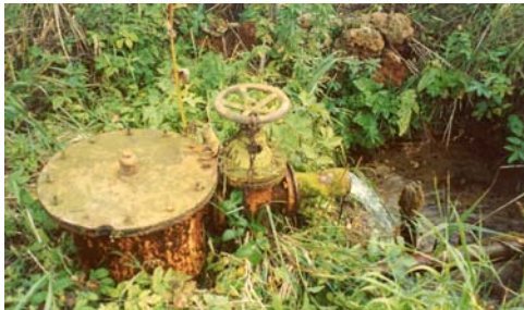
Artézský přetok podzemní vody z posuzovaného starého vrtu
