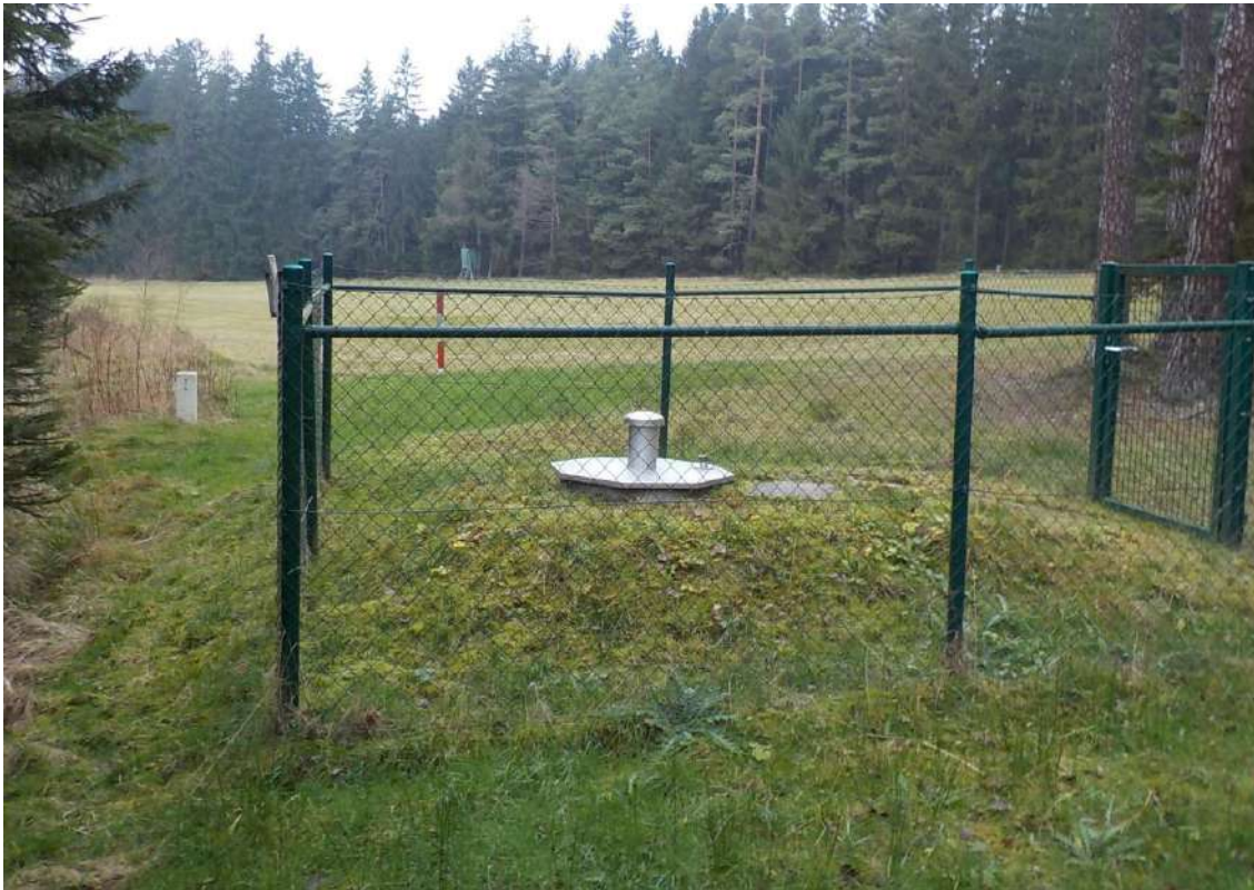
Obrázek 53 – Jímání Quelle Hölle III s bezvodou stružkou Pekelského potoka (vlevo)
