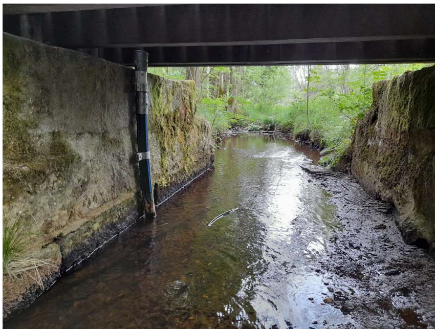
Obrázek 21. Vodoměrná stanice Újezdský potok
