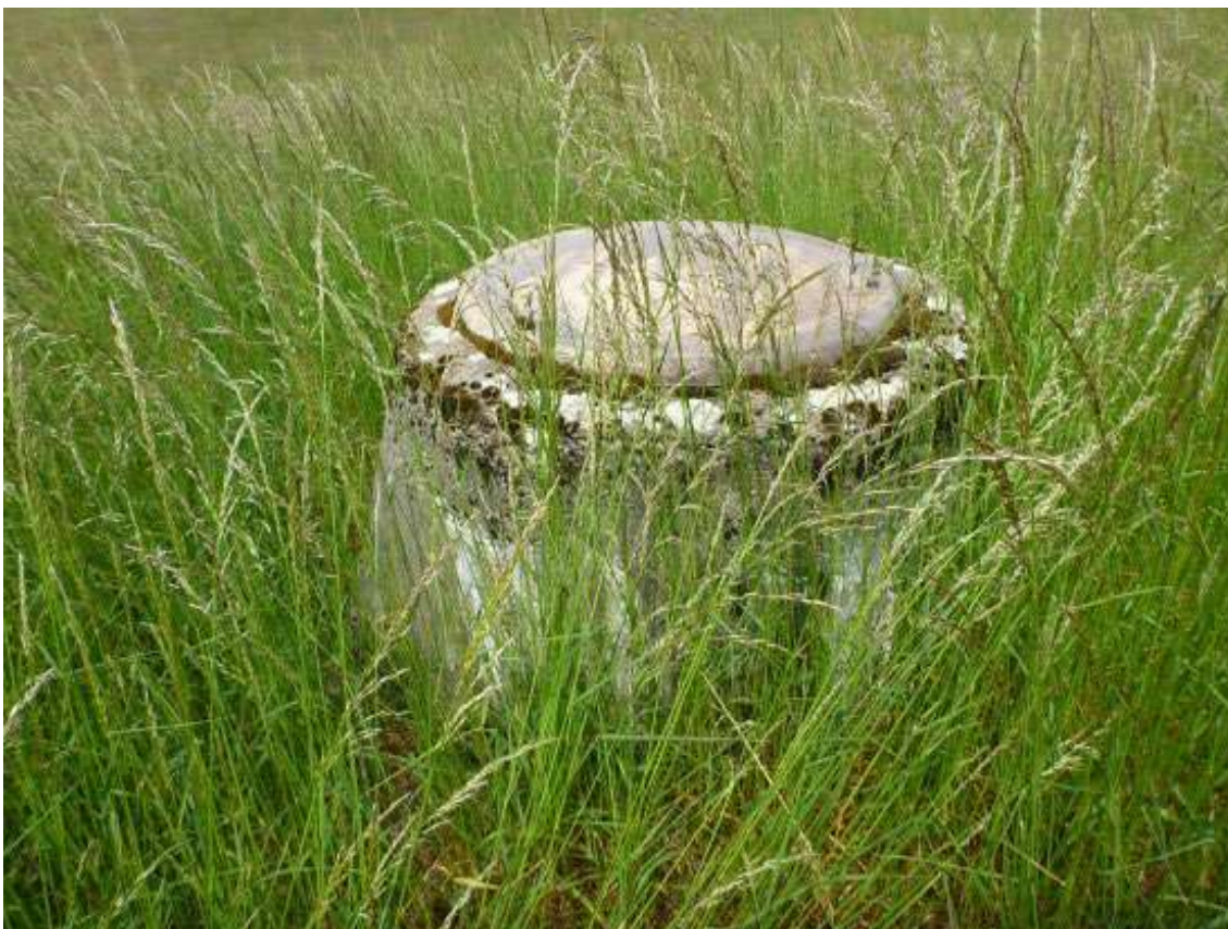
Obrázek 9. Šachta podpovrchového hlavního odvodňovacího systému, povodí Lužního potoka
