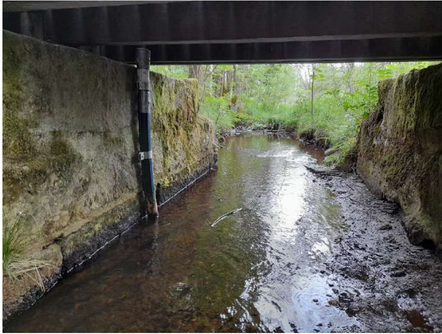
Obrázek 21. Vodoměrná stanice Újezdský potok
